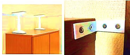
家具の転倒防止対策
